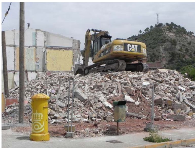
Enderroc del barri de L'Estació
